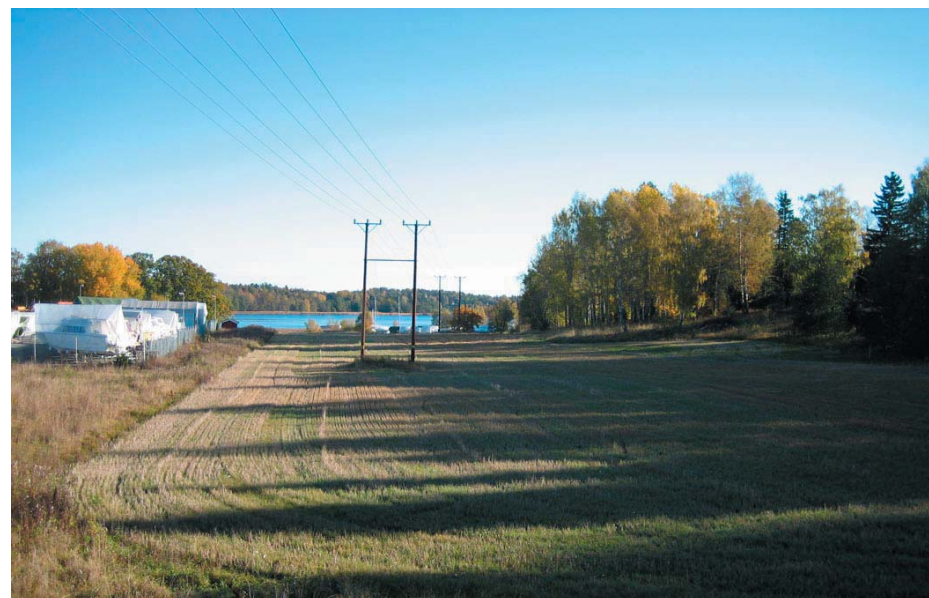
20 kV ledning vid Svinninge.
